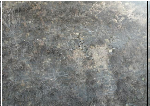
K33+650~K33+780 左侧二级护坡脱落
