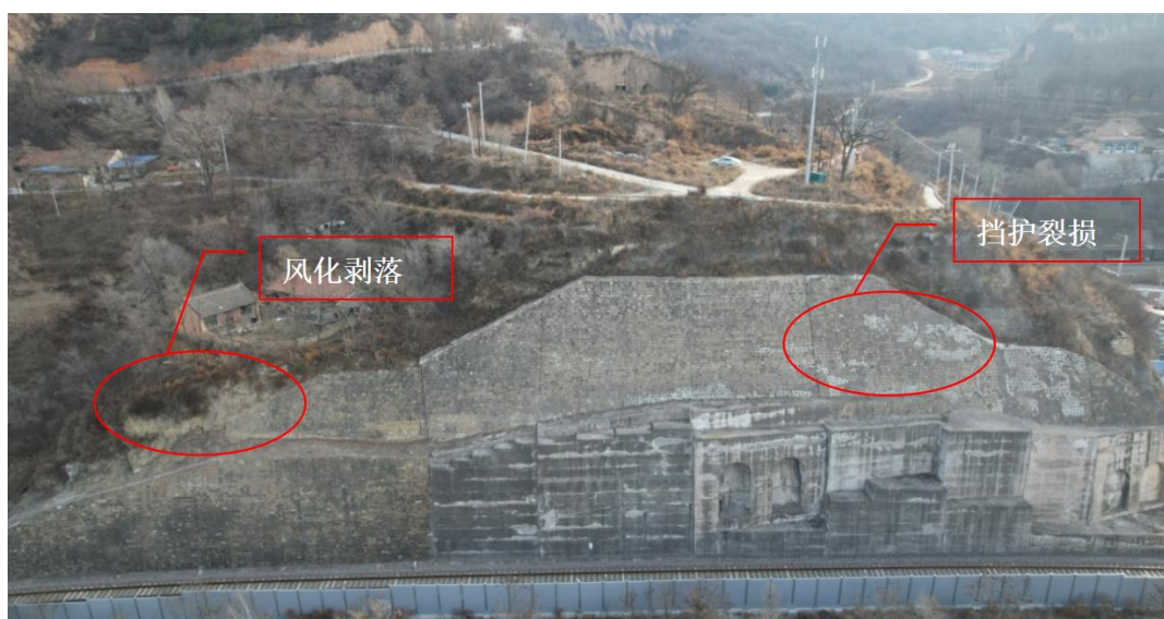
K34+480~+600 风化剥落病害全景
