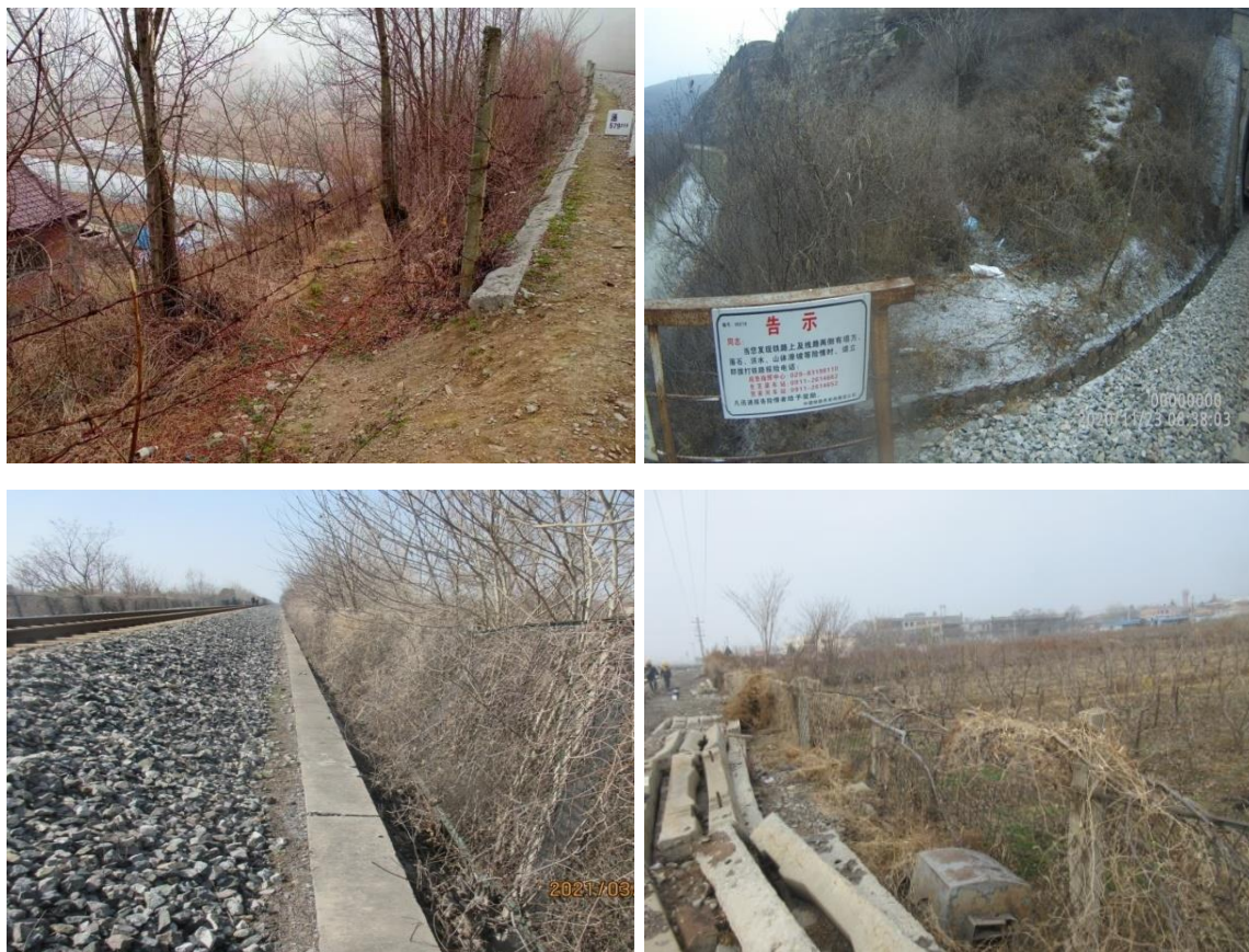
图 2.1-1 沿线防护栅栏不同程度破损或缺失
