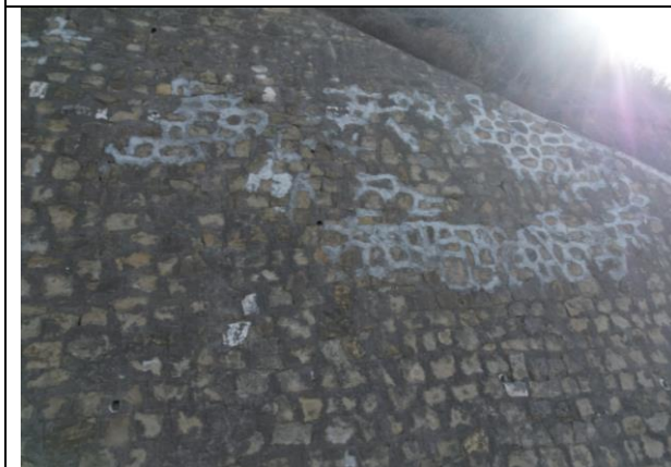
K34+480~+500 浆片护坡中部鼓裂
